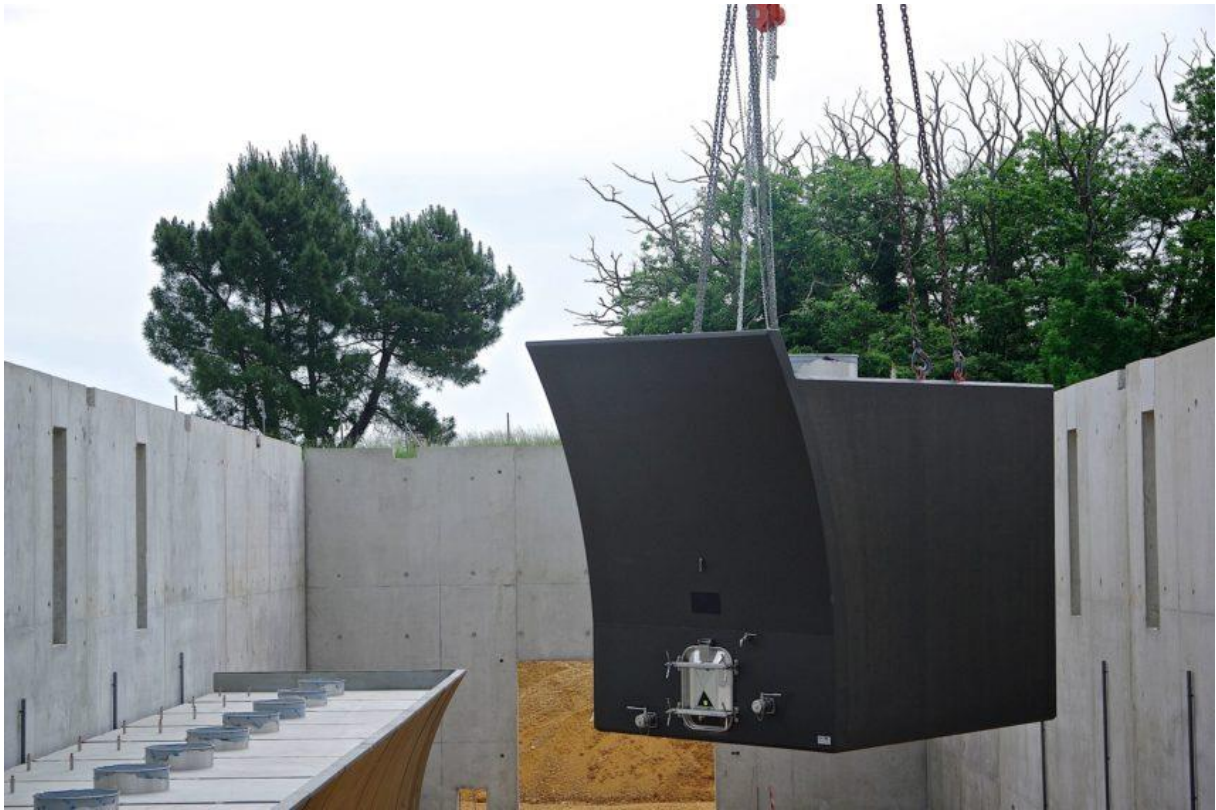
L'installation des cuiviers dans le nouveau chai. (©Frédéric Guy)
